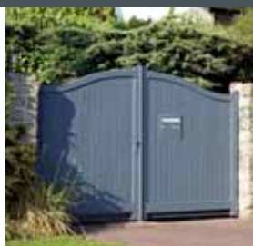
Boîte encastrée dans le portail
